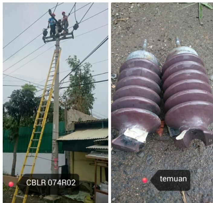
Gambar 3.5 Gangguan Akibat Isolator Pecah (25 Mei 2016 - Kopo)
