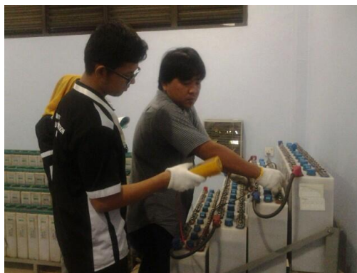
Gambar 19. Mengukur tegangan battery
