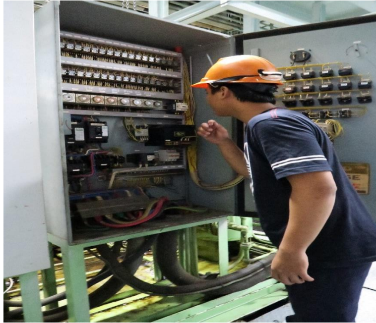
Gambar 3.2 Memeriksa kontrol panel
