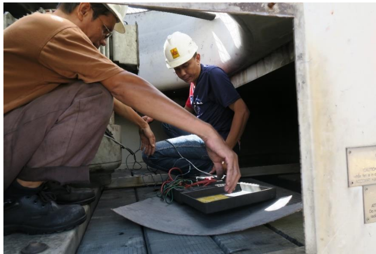
Gambar 3.4 Memeriksa sistem kontrol pada kipas pendingin (Radiator)
