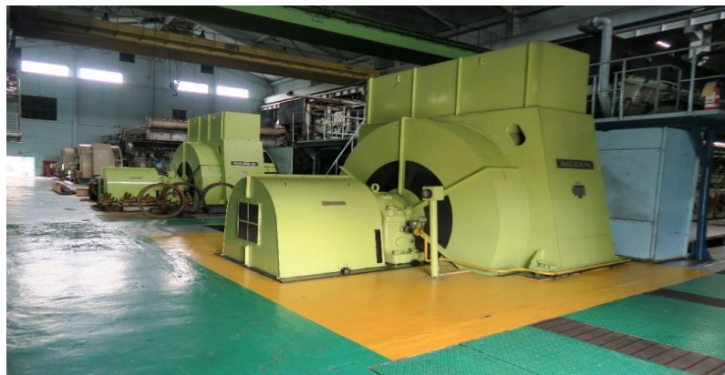
Gambar 3.8 Generator pada Pembangkit Listrik Tenaga Diesel
