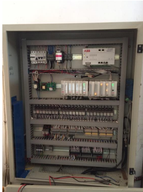
Gambar 13 Kondisi Perangkat yang Tertata Rapi
