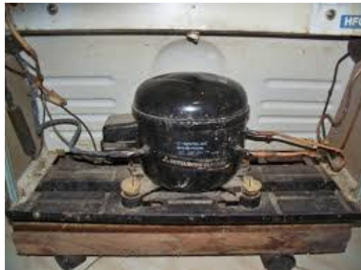
Gambar 3.15, Pengecekan kerusakan pada bagian belakang Pendingin
