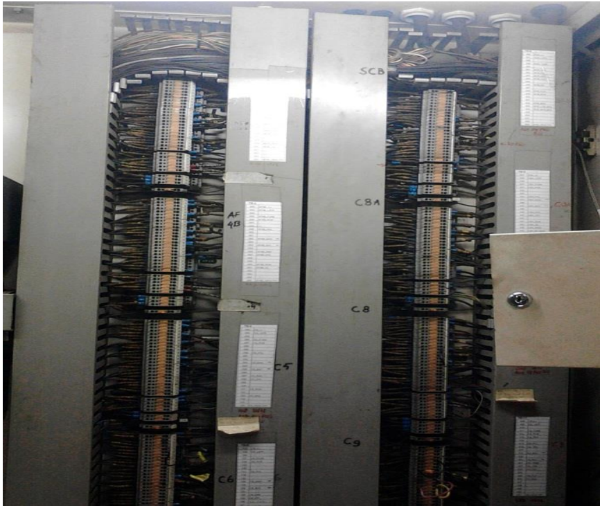
Gambar 3.8 Terminal pada control panel 2
