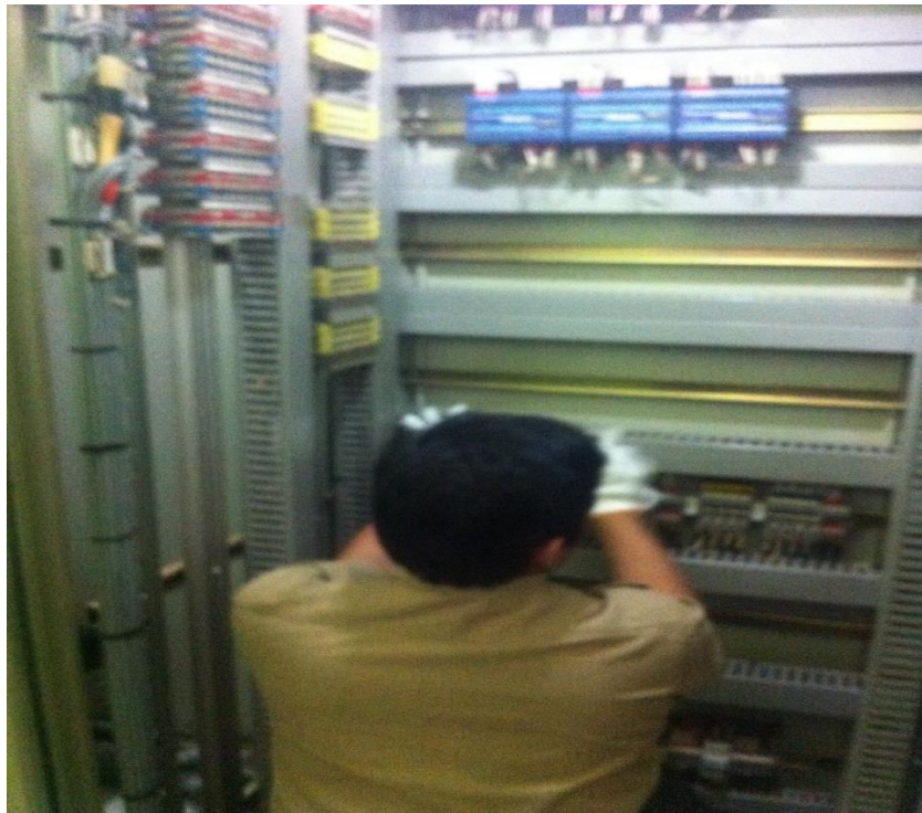
Gambar 3.11 Pemeliharaan Pada RTU dan Tranducer
