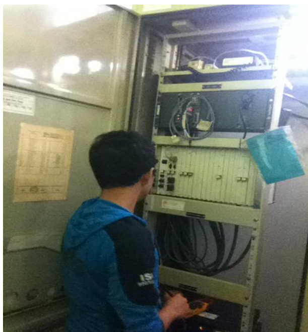
Gambar 3.12 Pemeliharaan Pada RTU
